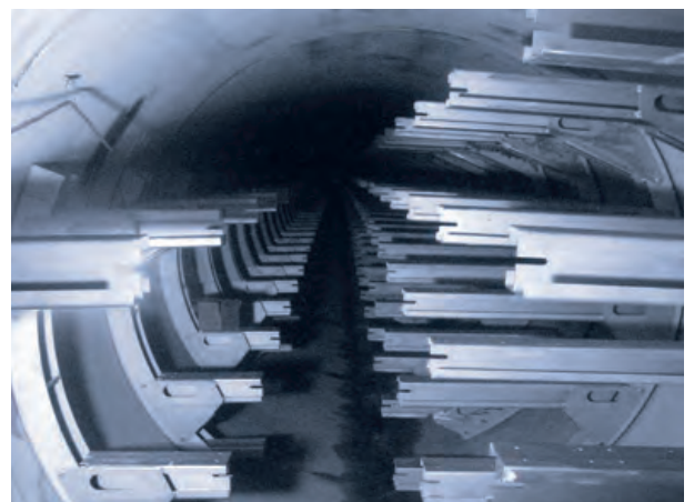
Projekt: Carlton Kabeltunnel, Australien (Bauherr: Energy Australien, Ausführendes Unternehmen: The Abergeldie Group, Kabeltrassen: Leviat)
