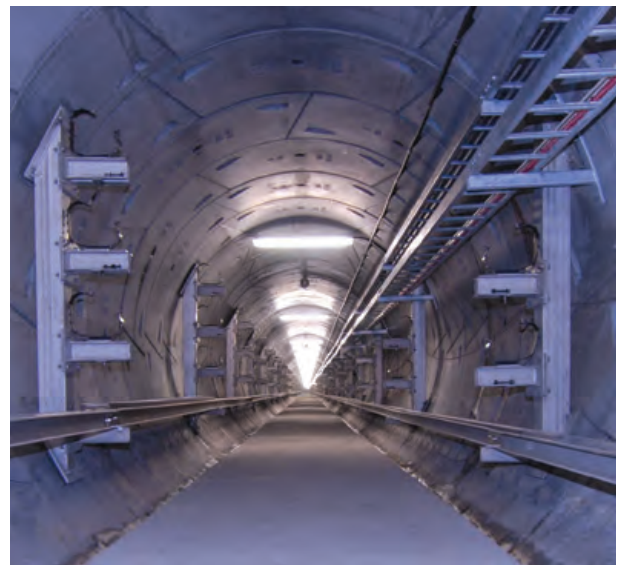
Projekt: Kabeltunnel City West, Australien (Bauherr: Energy Australien, Ausführendes Unternehmen: Theiss, Bauleitung: Maunsell/Aecom)
