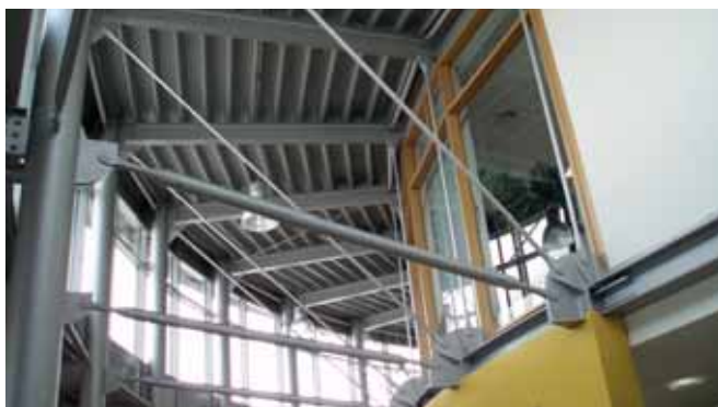
Contreventement entre un poteau extérieur en acier et une poutre intérieure en acier
